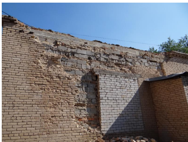
Рис. 4. Аварийное разрушение карниза и стены одноэтажного здания
