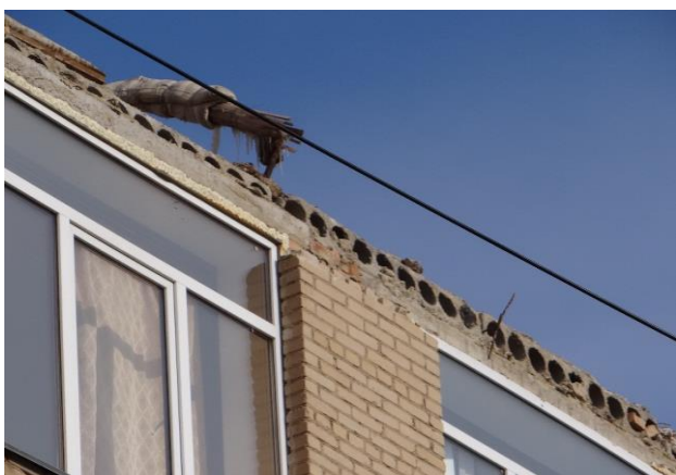
Рис.2. Аварийное разрушение карниза четырехэтажного здания
