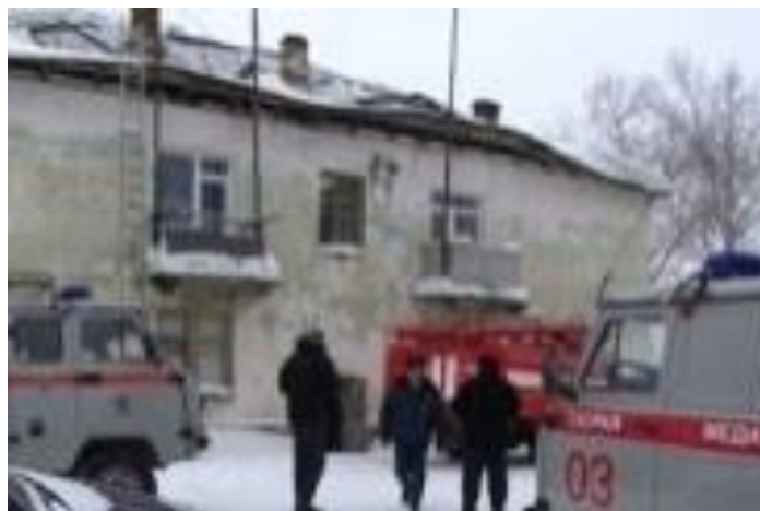
Рис. 10. Обрушение крыши двухэтажного барака в пос. Билимай
