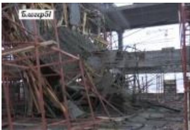
Рис. 3. Обрушение конструкций строящегося объекта в г. Мурманске
