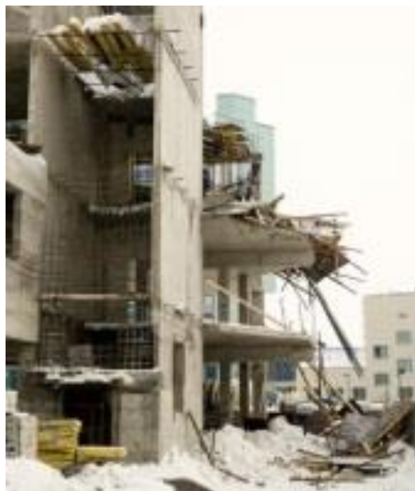
Рис. 6. Обрушение бетонного перекрытия в строящемся офисном здании в г.Сургуте
