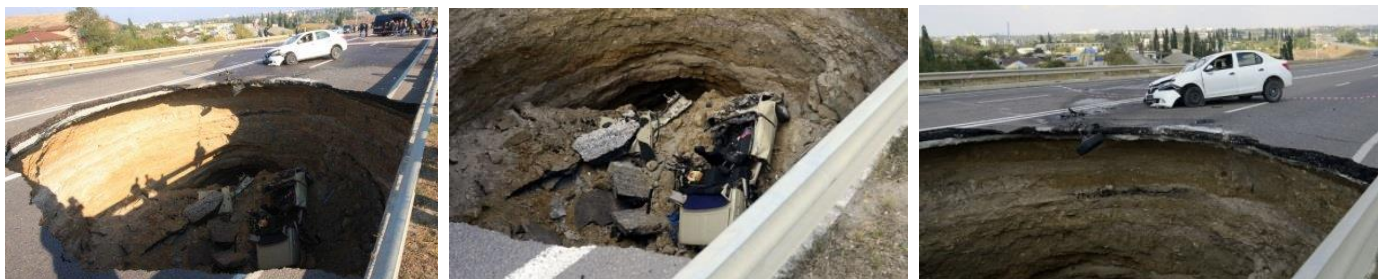
Рис. 7. Обвал дороги на участке объездной дороги Симферополя
