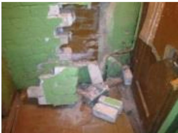
Рис. 9. Обрушение части стены в подвале жилого дома в г.Перми
