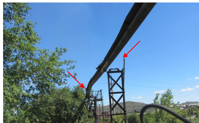
Фото 2. Смещение с опор газопровода и гибка труб в результате механического воздействия (данный участок газопровода располагается над дорогой)
