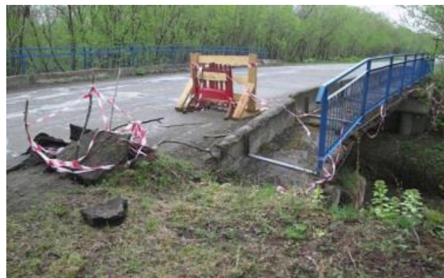
Рис. 13. Частичное обрушение примыкания автодороги к мосту в г.Южно-Сахалинске
