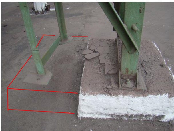
Фото 1. Отсутствие фундамента под опорой газопровода
