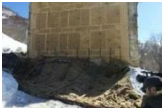
Рис. 2. Обрушение утепляющей обшивки с торца дома в г. Петропавловск-Камчатский
