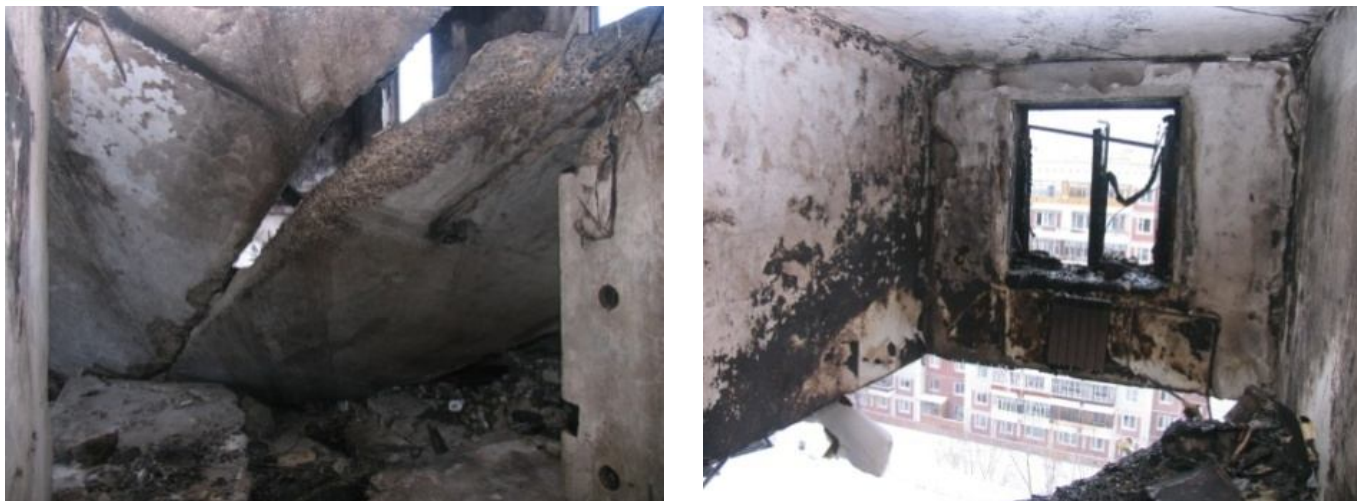
Рис. 3. Фрагменты разрушенных участков перекрытий
