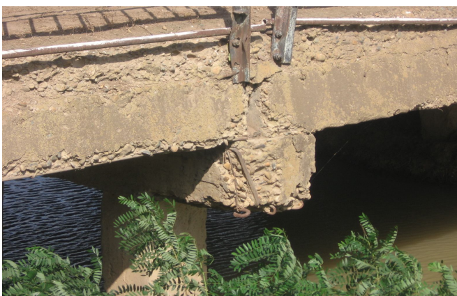
Рис. 3. Разрушение несущих элементов мостового переезда
