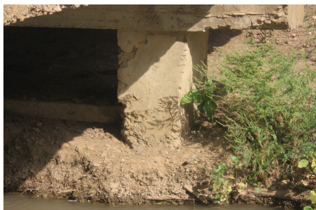
Рис. 4. Разрушение несущей колонны мостового переезда
