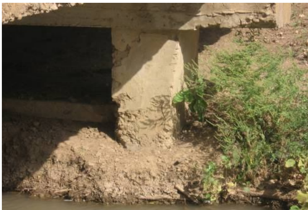
Рисунок 4 – Разрушение несущей колонны
