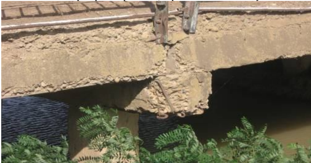
Рисунок 3 – Разрушение несущих элементов мостового переезда
