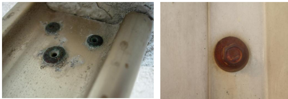
Рисунок 4. Электрохимическая коррозия вытяжных заклепок и винтов.
