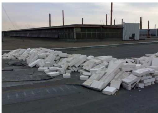
Рис. 1 - Характерное нарушение правил проведения строительно-монтажных работ
