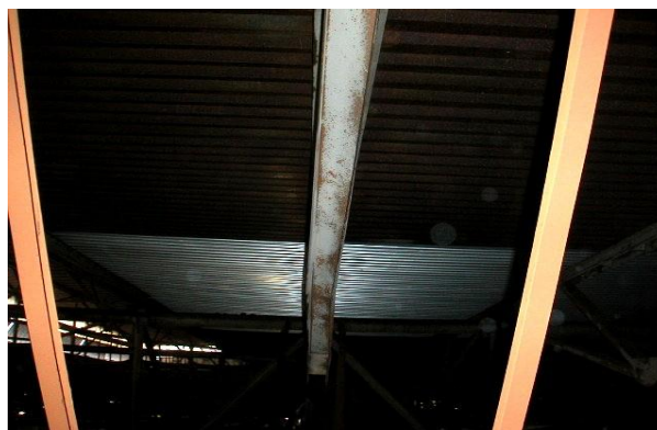
Рис. 4 - Состояние профилированного настила, эксплуатирующегося в травильном отделении
