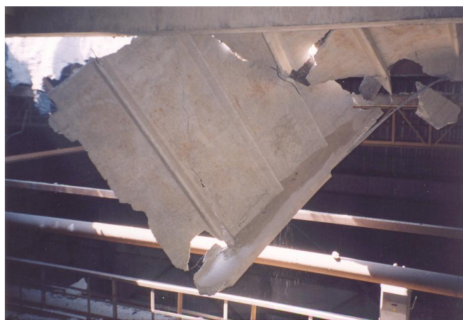
Рис. 5 Обрушение плиты покрытия
