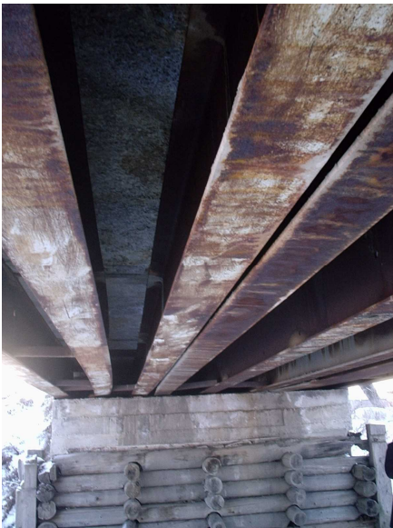
Рис. 3. Опираие балок на устой по оси 1. Деформация (искривление) балок.
