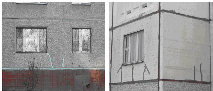
Рис. 1. Расположение трещин. Cracks location.
