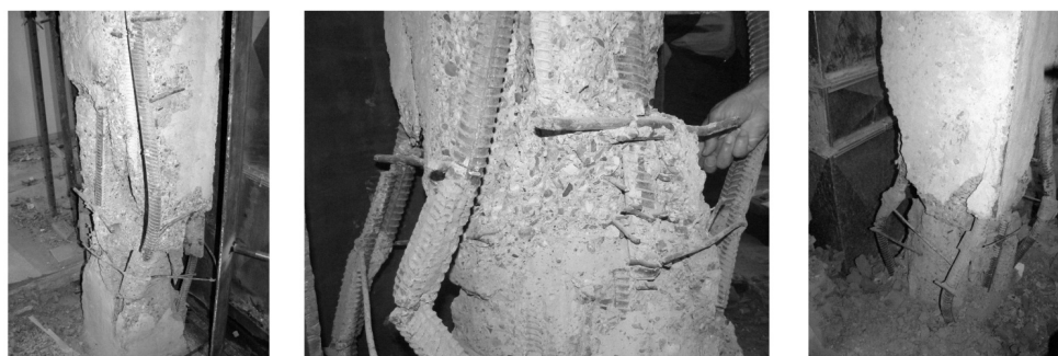
Рис. 3. азрушение стыков железобетонных колонн кардиологического центра в г. Кемерово. The destruction of joints ferro-concrete columns of the cardiologic center in Kemerovo.
