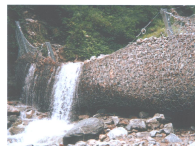
Рис.5. Защита водопропускного сооружения гибкими многоуровневыми селевыми барьерами.
