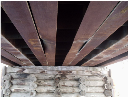
Рис. 2. Опираие балок на устой по оси 4. Полки балок деформированы.
