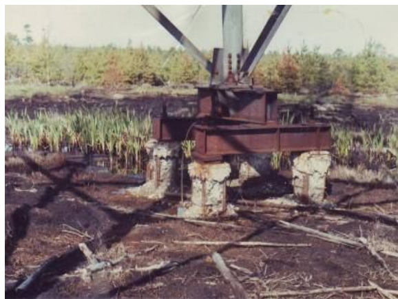
Рис. 1. Свайные фундаменты опор ЛЭП, находящиеся в аварийном состоянии
